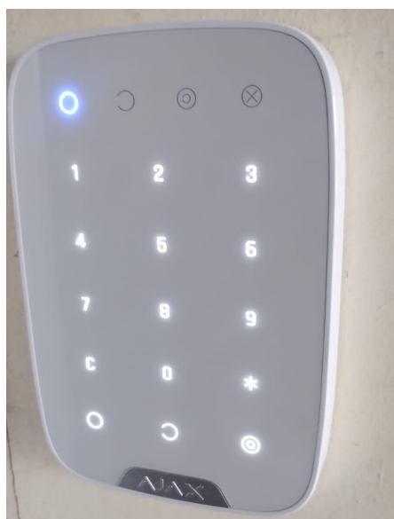
Fig. 2. Estado del teclado cuando el sistema de alarma está activado o parcialmente desactivado.
